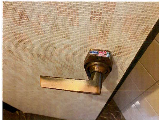
【施工後：個室トイレドアノブ（内側）】
